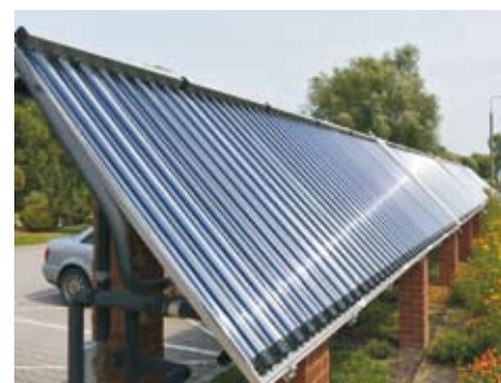
Kolektory słoneczne w CEE
