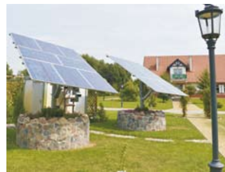
Panele fotowoltaiczne w CEE
